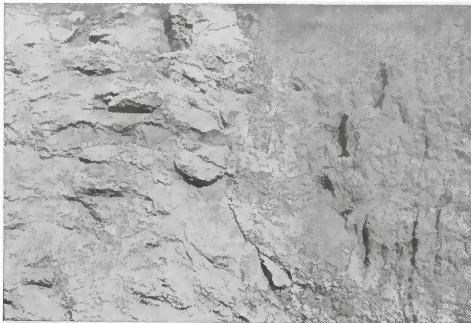
FOTO 13 — RODOVIA MARÍLIA-BAURU — Km 418 — Altitude 585 m. Falha no arenito Bauru
